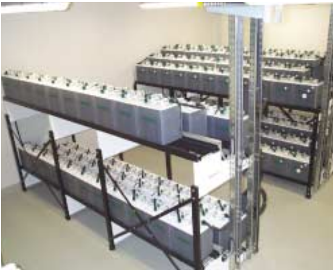
Batterieanlage auf Gestellen
